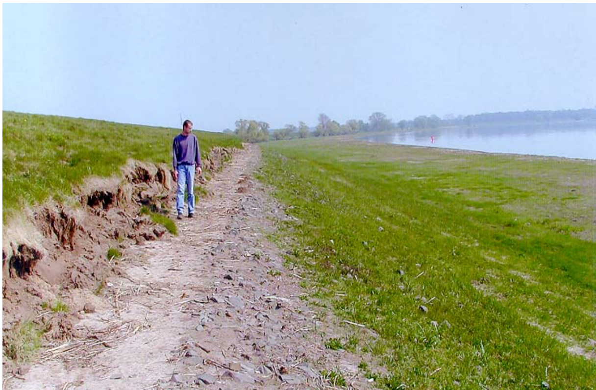
Abbildung 12: Deichschäden durch Eisschollen (Quelle: MESECK et al. 2004).
